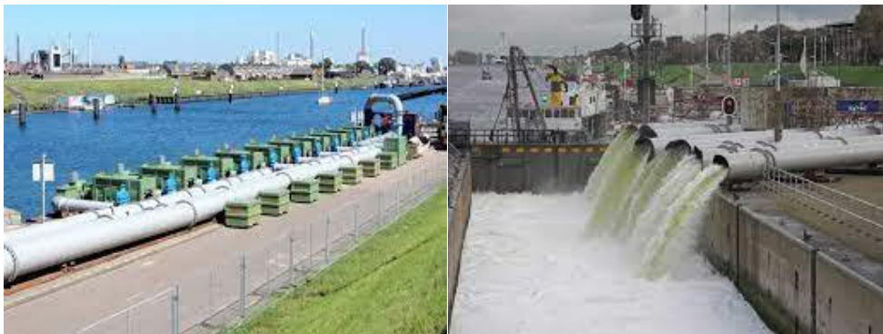
Figuur 2: impressie van de opstelling van 10 van in totaal 31 noodpompen in IJmuiden, links aanzuigzijde en rechts de uitstroom.
